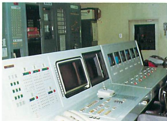
●防災センター
